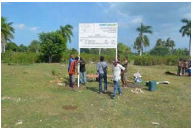
Pesquisa ao local e instalação da placa para o posto de abastecimento de combustível
